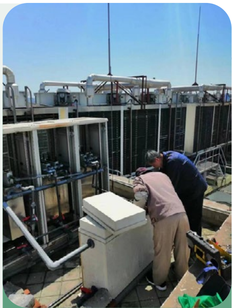
中央空调冷却水处理设备
